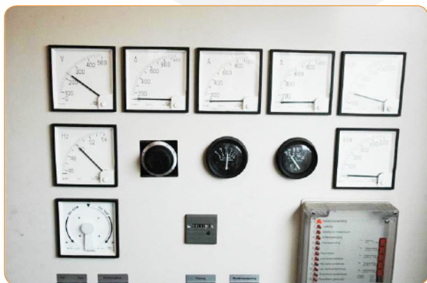
Instrumenter fra et nødstrømsanlæg.
